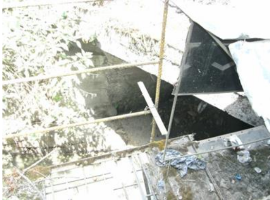
Fotografía N° 3.17: Estrangulamiento "La tienda". Punto crítico por la alta probabilidad de atascamiento o represamiento.
