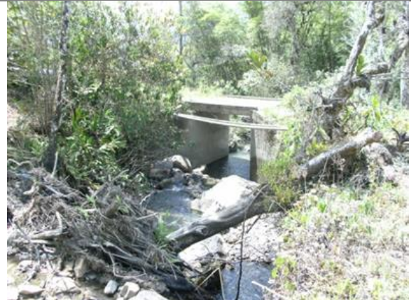
Fotografía N° 3.10: Inestabilidad por represamiento y presencia de empalizada.
