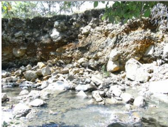
Fotografía N° 3.5: Re-trabajamiento del recubrimiento aluvial (inestabilidad de orillas).
