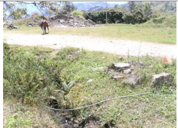
Fotografía N° 3.24: Espesor crítico del relleno en la determinación de la carga portante de la superficie. Riesgo alto por subsidencia.
