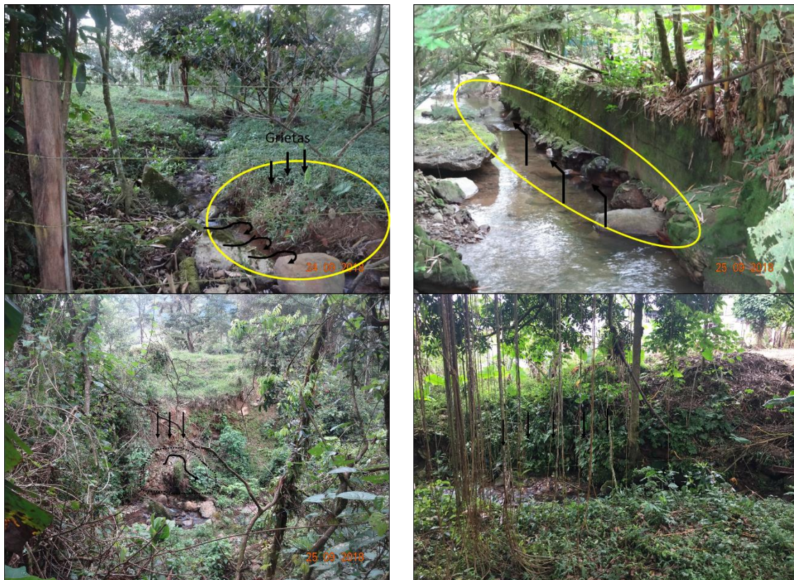
Figura 10-22. Socavación y desplomes del caño Poblano, municipio de Mámbita, vereda Mámbita Centro.
