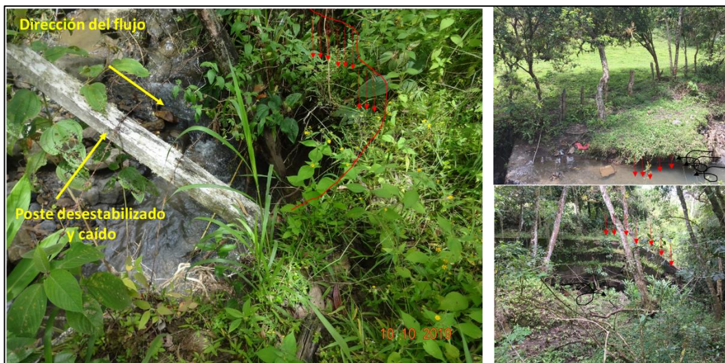
Figura 94. Socavación y desplomes en la quebrada la esperanza Fuente: PI Planificación Integral Consultores, 2019
