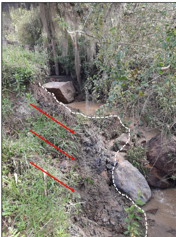
Fotografía 11.1. Movimiento en masa en el escarpe de la loma de la Quebrada El Chulo (Norte: 2090792,78342/Este: 4930271,44059)
