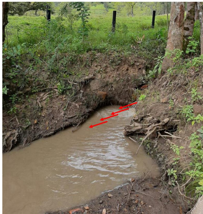
Fotografía 11.2. Socavación lateteral en la Quebrada El Chulo (Norte: 2090943,97185 /Este: 4930410,84213)
