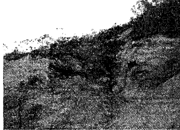
Desprendimiento de taludes.
